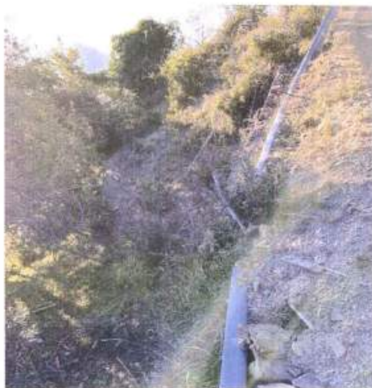
Foto 5 – particolare dissesti barriera di protezione
