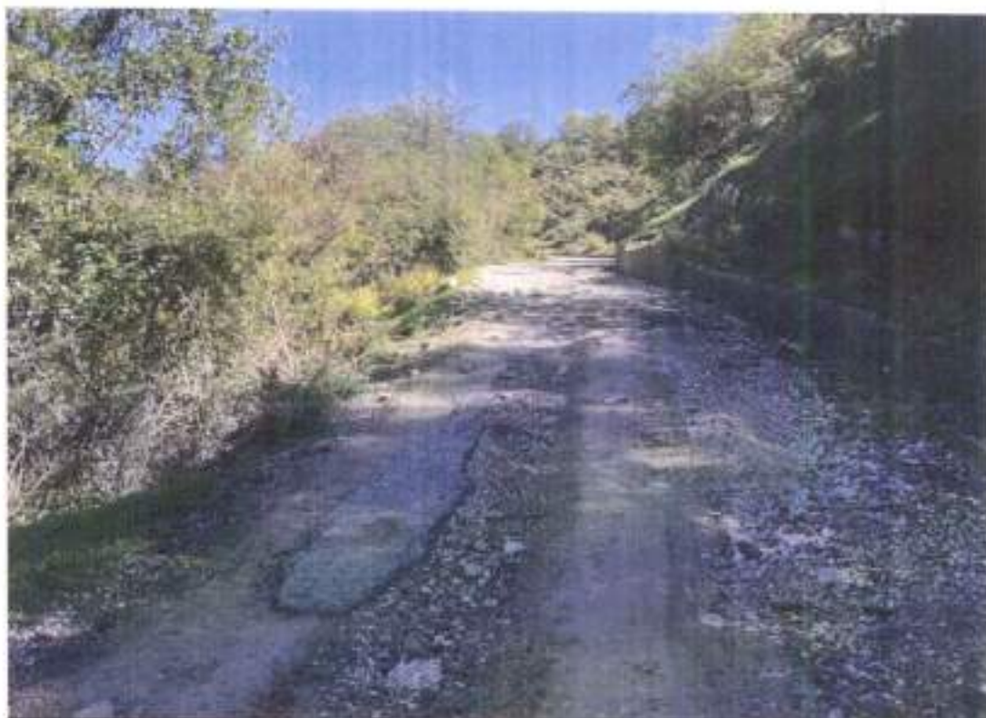
Foto 3 – particolare dissesti manto stradale
