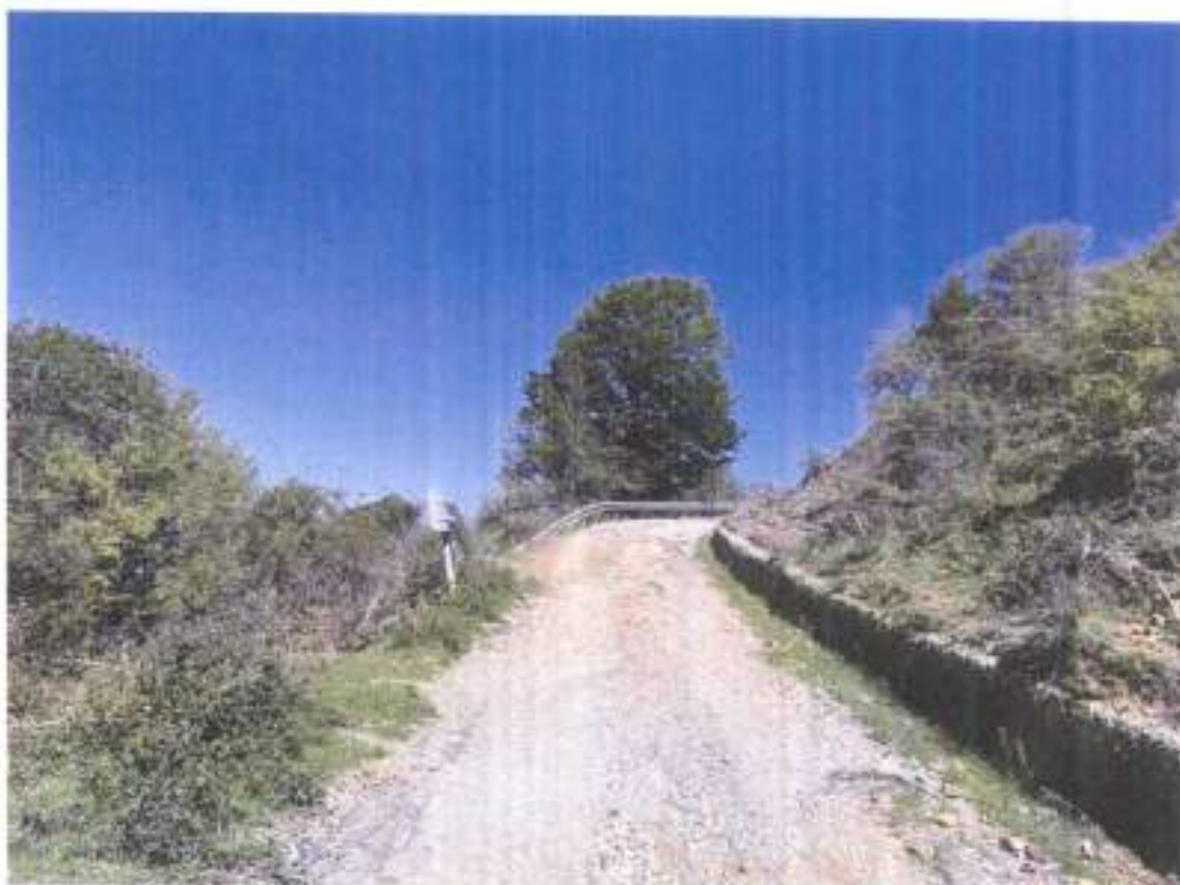
Foto 1 – particolare dissesti manto stradale
