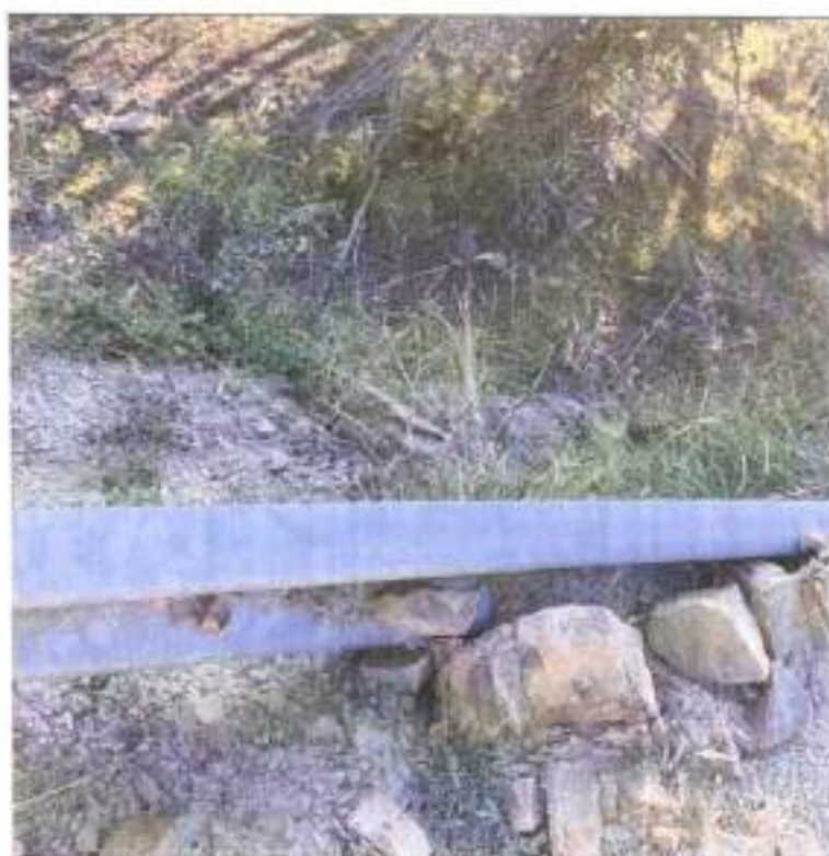
Foto 6 – particolare dissesti barriera di protezione
