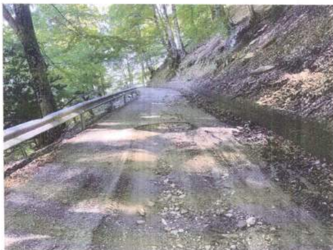
Foto 4 – particolare dissesti manto stradale
